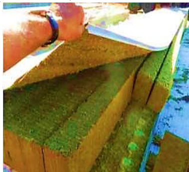
а) відшарування утеплювача від сталевго листа покрівельної сендвіч-панелі з мінеральної вати
